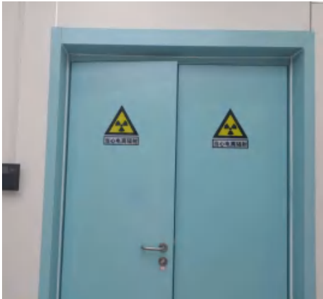
(a) 控制区入口当心电离辐射警告标志
