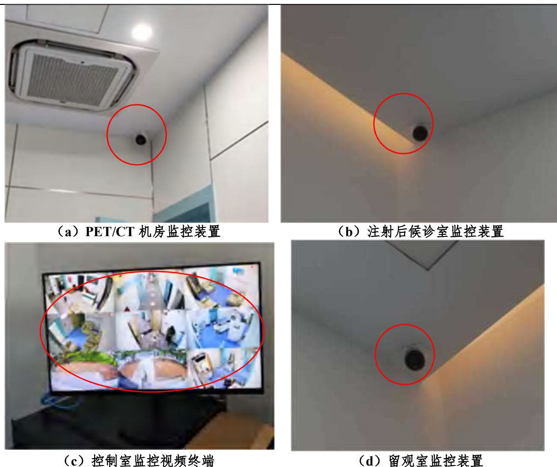
图 3-4 本项目监控装置（部分区域）
