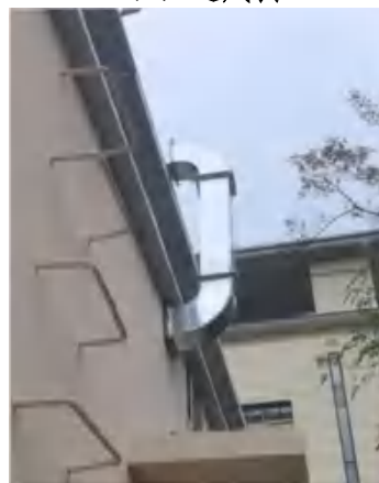
(d) 室外排风管道
