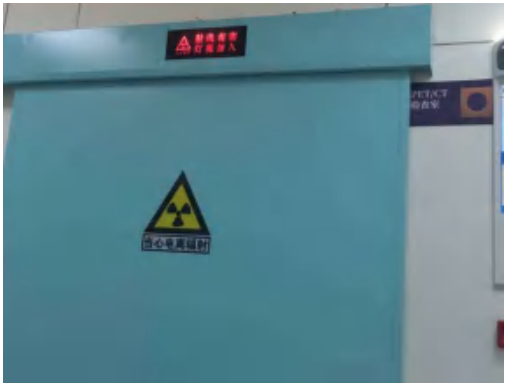
(c) PET/CT 机房当心电离辐射警告标志及工作状态指示灯
